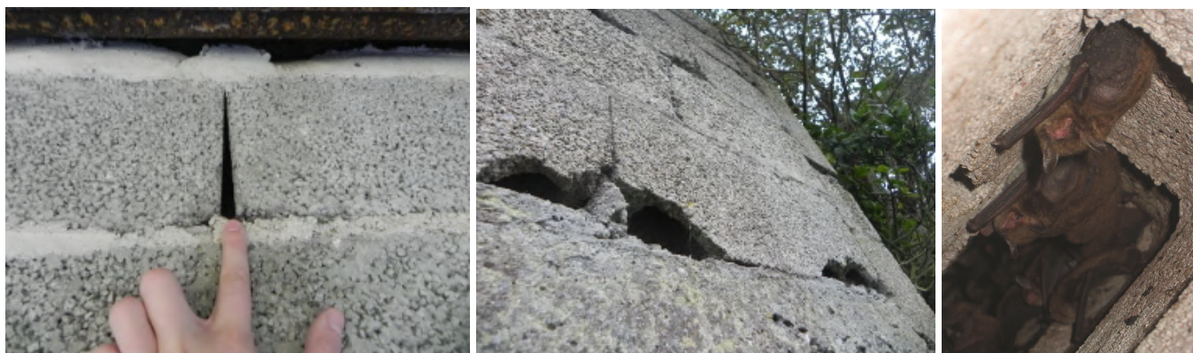
Joints réservant des anfractuosités
